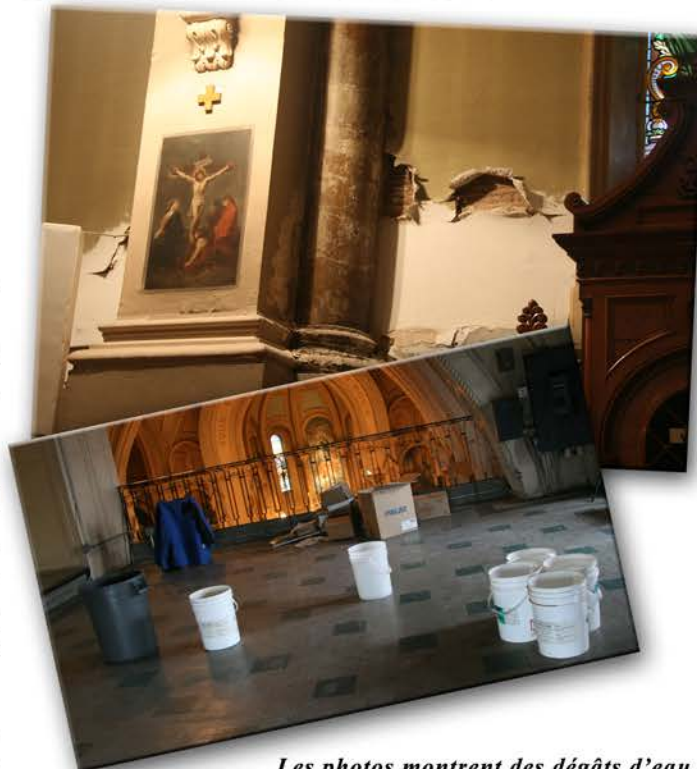
Les photos montrent des dégâts d'eau à l'église de l'Immaculée-Conception. Heureusement le toit est maintenant refait. Mais il y a encore beaucoup à faire.
