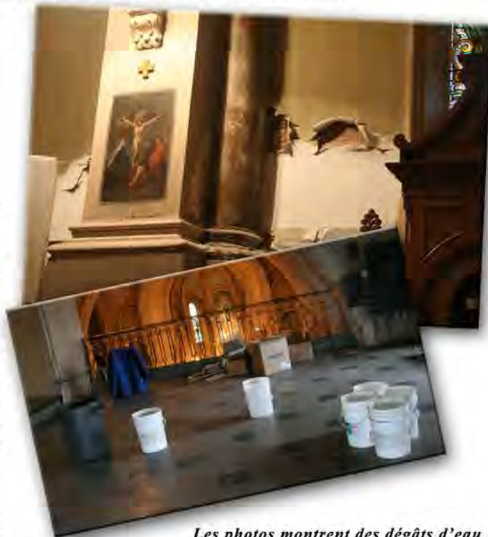
Les photos montrent des dégâts d'eau à l'église de l'Immaculée-Conception. Heureusement le toit est maintenant refait. Mais il y a encore beaucoup à faire.
